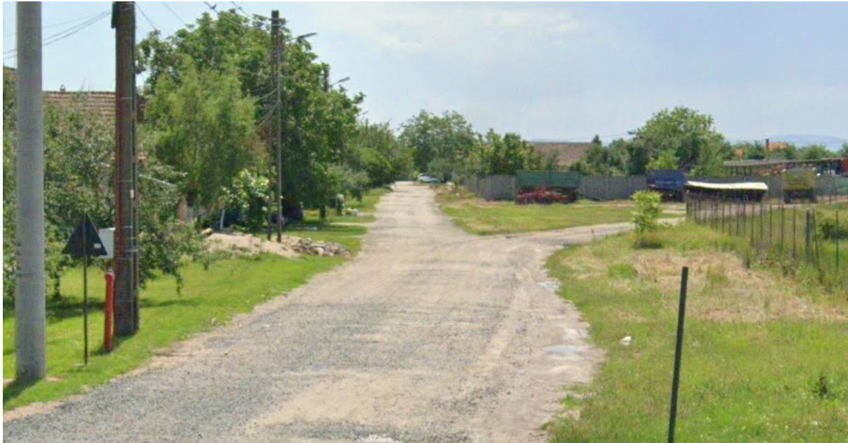
Figura 20 Exemplu stradă nemodernizată- strada Plopului, Sântana
