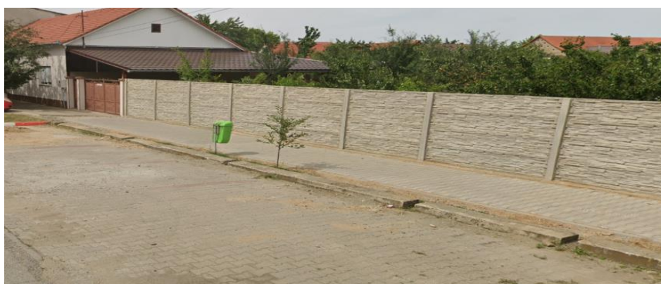
Figura 37 Trotuar sub-dimensionat, strada Ghiocilor, oraș Sântana
